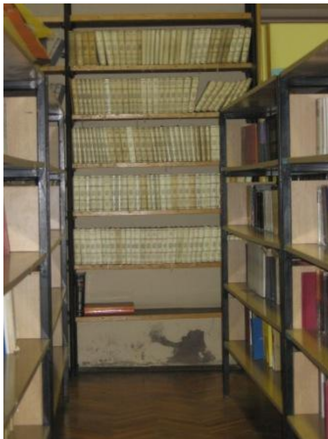
Slika 2. Vlaga na zidovima
